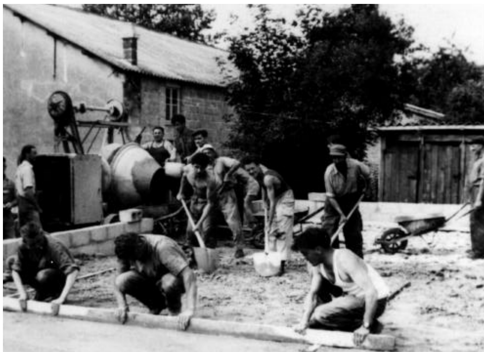
La construction du quillier en 1960. À l'arrière plan, l'ancienne salle du Réveil.
