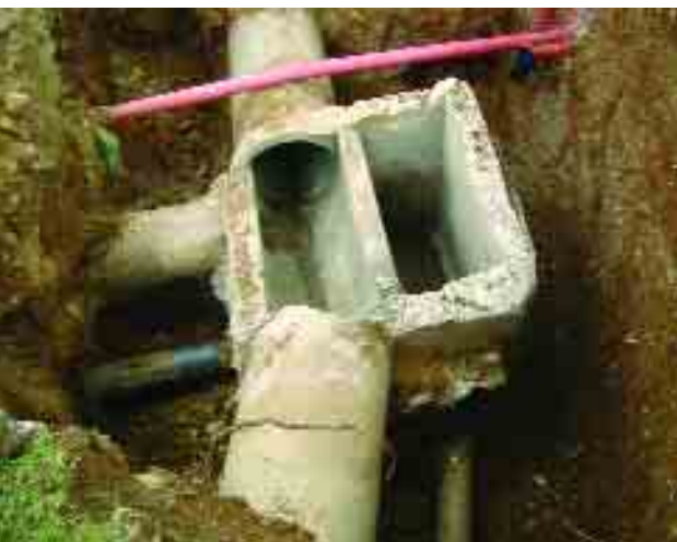
Regard mixte. Le déversement des eaux de pluie dans les eaux usées est inévitable.
